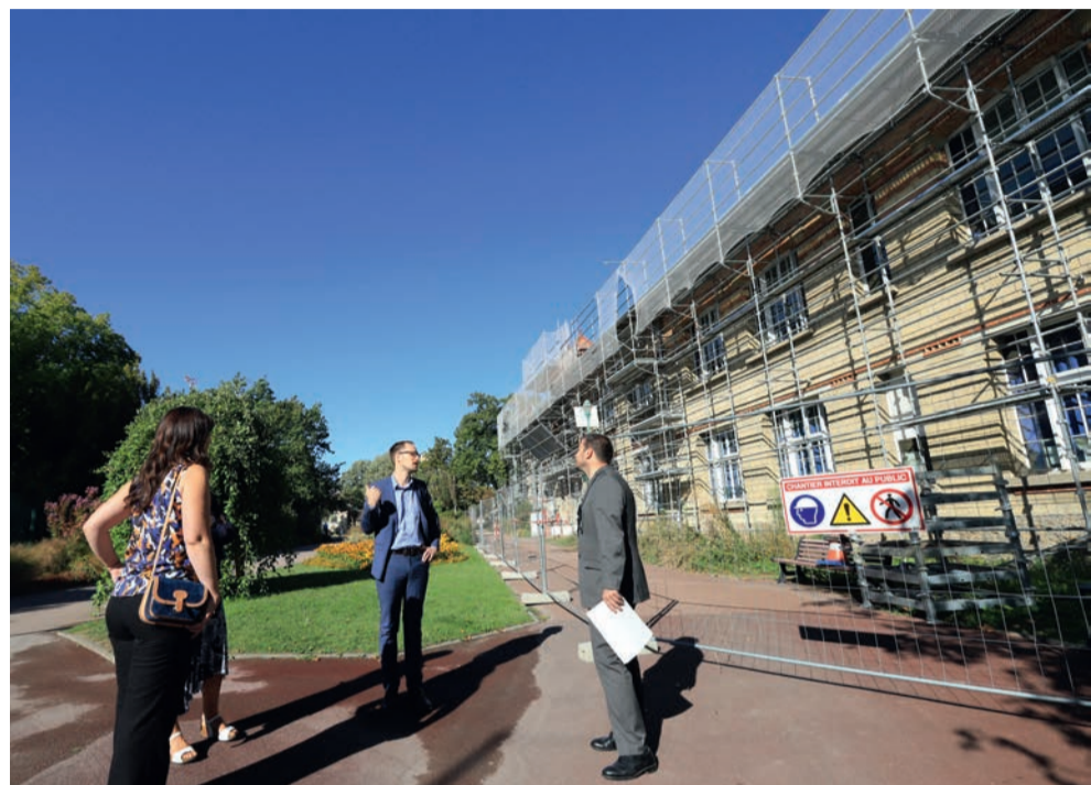
Durant l'été, la Ville a procédé à la réfection complète de la toiture de l'école Jules-Guesde (remplacement des tuiles et des liteaux et rénovation de l'isolation).
